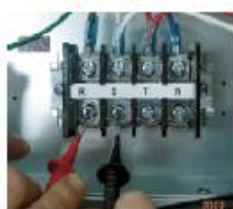
Измерение питающего напряжения
