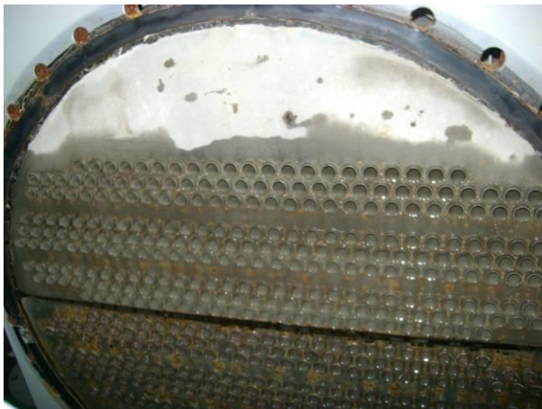
Загрязненная изоляционная труба
